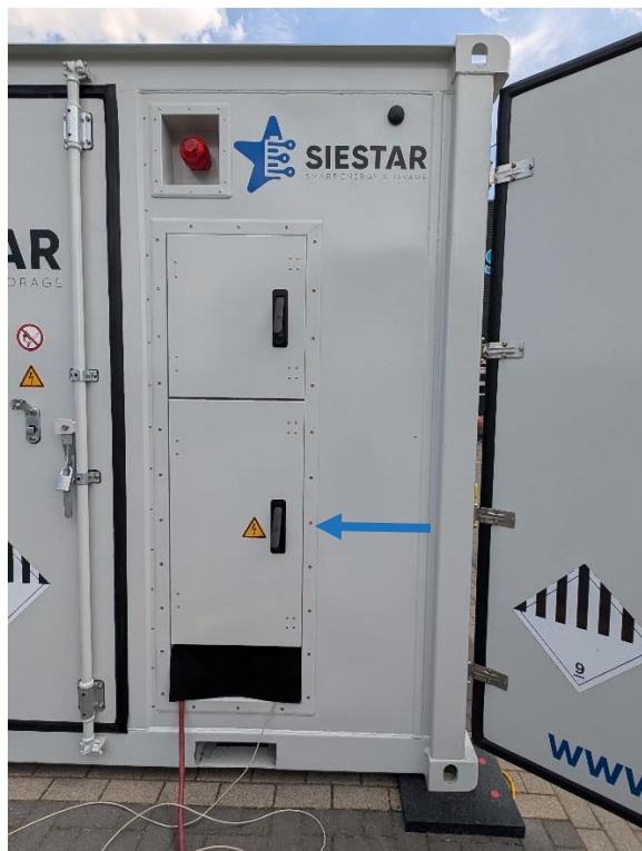
Figuur 19. Locatie van de Powerlock connectoren in de container
