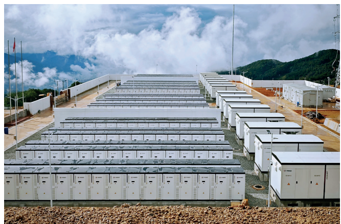
T418 batterij energie opslagpark
